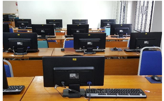
Pendawaian/kabel yang kemas dan selamat
