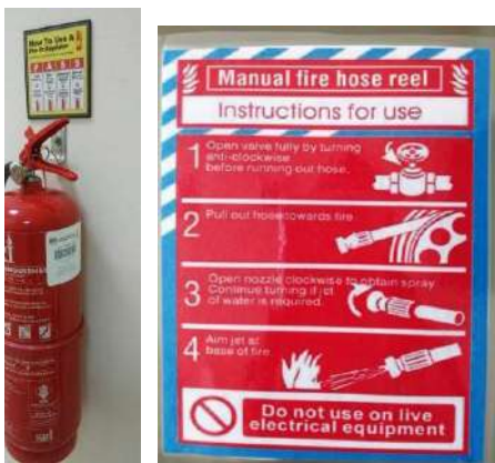
Peralatan Pencegahan Kebakaran
