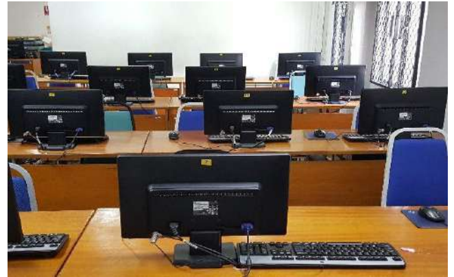
Pendawaian/kabel yang kemas dan selamat
